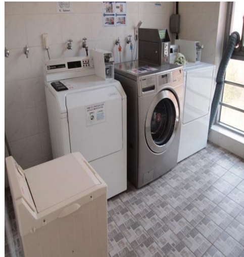
〈Laundry Machine and Dryer〉
